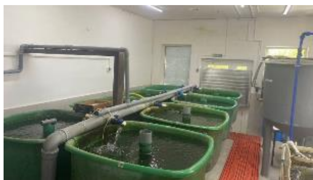
Рис. 1. Установка замкнутого водоснабжения
